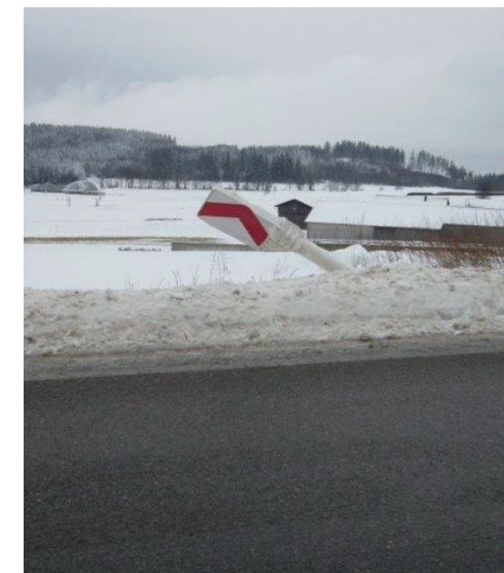
Abb.25: Beispiele durch Sturmböen (links) und Winterdienst (rechts) beschädigter flexibler Richtungstafeln
